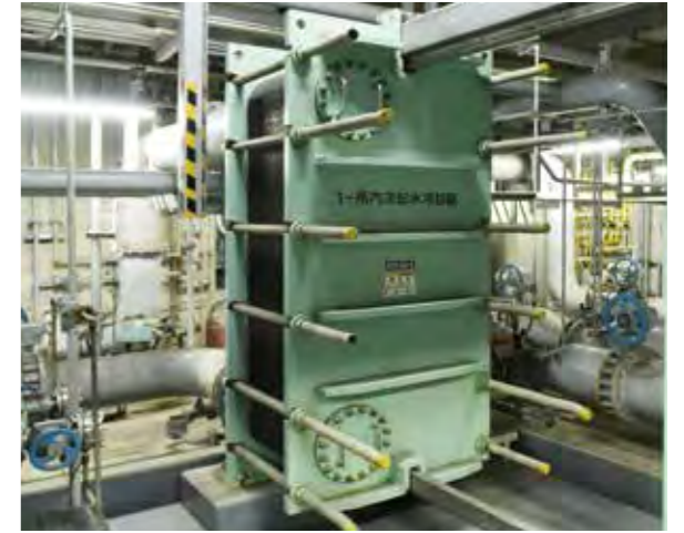
발전 플랜트의 베어링 냉각수의 냉각
